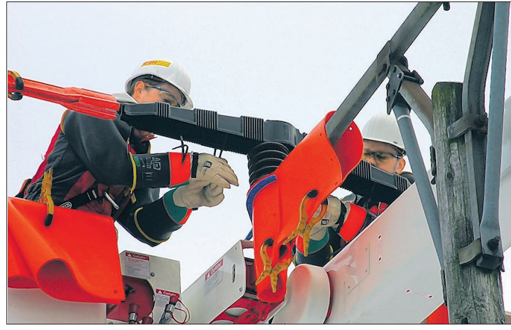
Solange die schwarzen Schutzhauben noch nicht auf den Isolatoren montiert sind, bleiben auch die sichernden Kautschukmatten (orange) auf Leitungen und Traversen.
